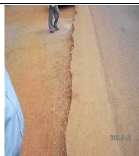
Road edge not protected
